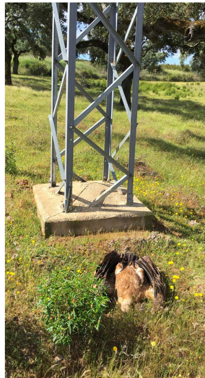
Los accidentes con infraestructuras energéticas constituyen una seria amenaza para los buitres.
